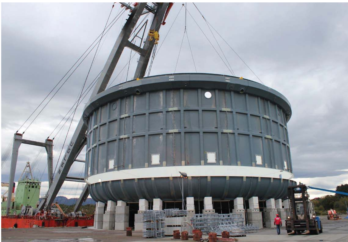
Lukket betonganlegg fra FLO Marine.
